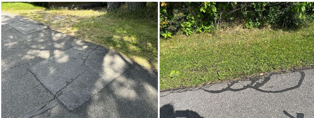
Figur 4.5.3 Rødder: Tofte-Åsen (tw) og skader pga. vand: Tofte-Åsen (th).
