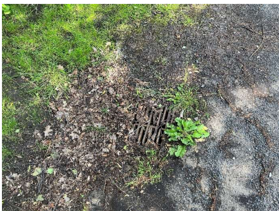
Figur 4.5.3 Tilstoppet rist: Byøgeren.
